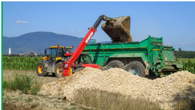
Chantier de chargement de boues de Kronembourg pour épandages. © Suez Organique, C.Duringer
